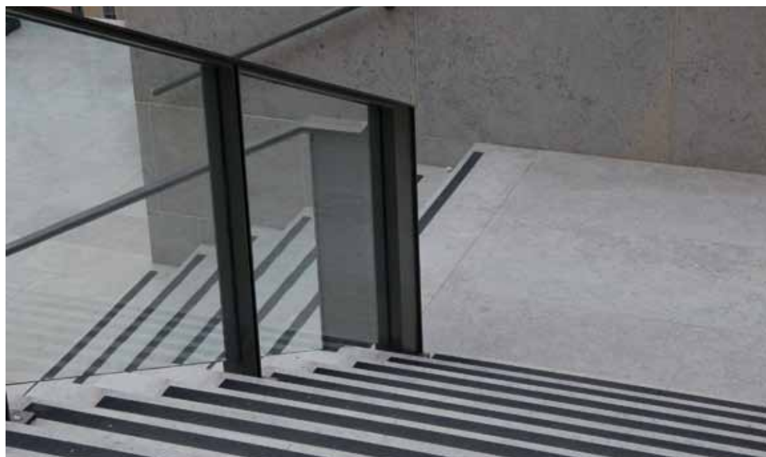
De trappen in het entreegebied van het Rijksmuseum zijn vlak na oplevering voorzien van trederandmarkeringen om het valrisico te verkleinen.
